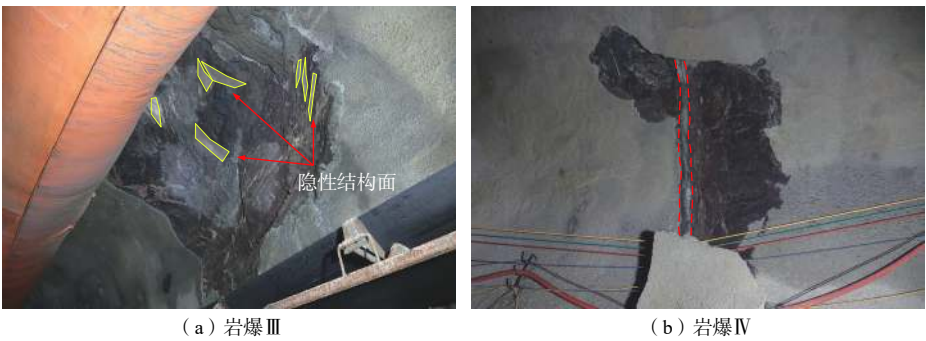
图 8 岩爆区域内的结构面 Fig. 8 Structural plane in rockburst area
