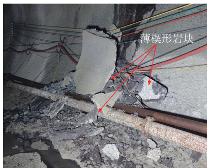
图 9 岩爆 IV 爆堆 Fig. 9 Rockburst IV pile
